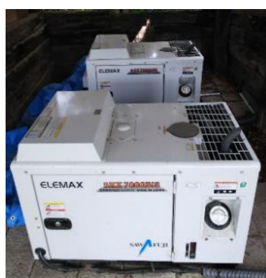
BDF 製造装置および発電機
