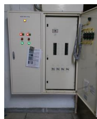
発電機との系統連系配電盤
